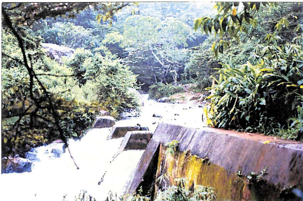
Figura 27 Arriba del sitio conocido como La Fonda: Estructura Captación de agua para generación de Energía (fuera de servicio).
