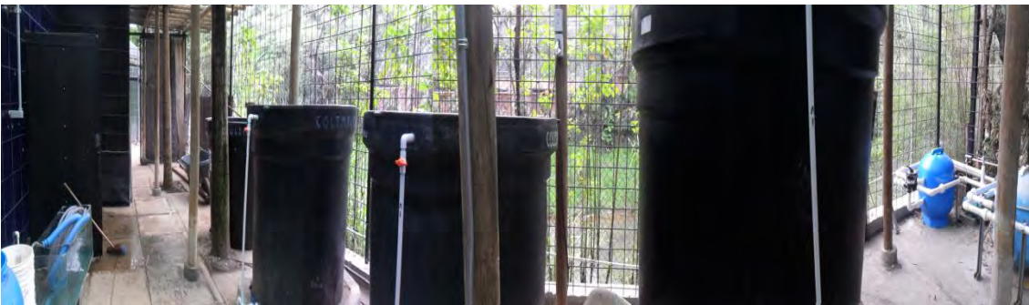
Ilustración 15. Tanque de reserva en Zona de Marinos
