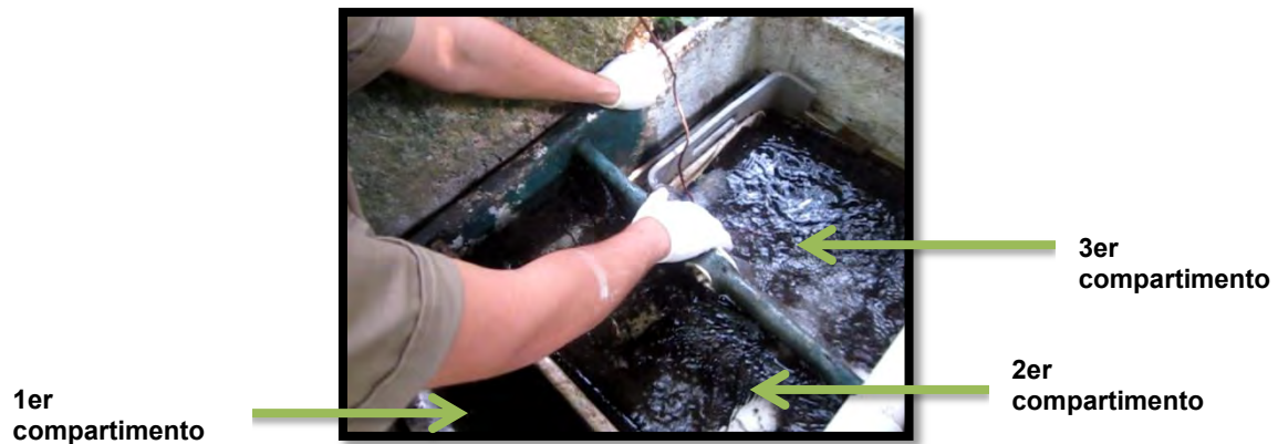
Tanque de Sistema Filtración
