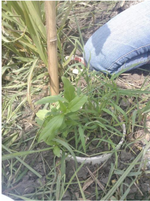
Ilustración 24: Cámara con alto crecimiento de hierba al interior
