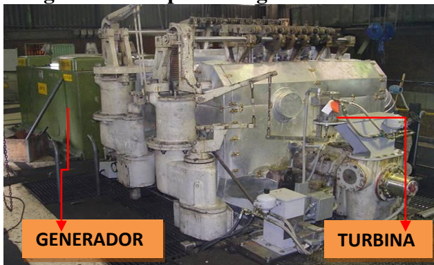
Fotografía 1. Grupo Turbogenerador existente
