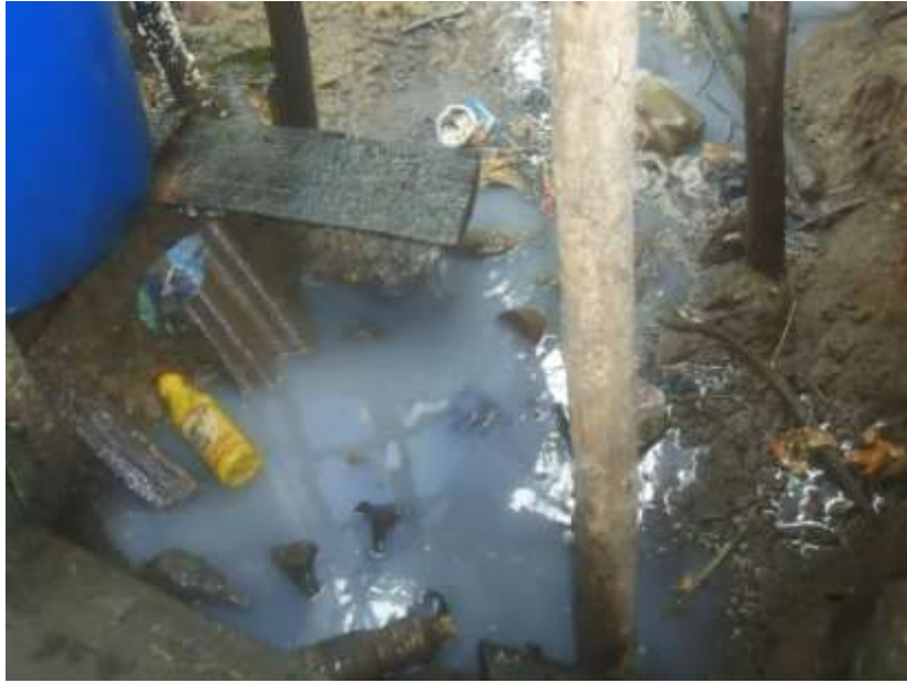
Imagen 30: Agua residual vertida en el suelo
