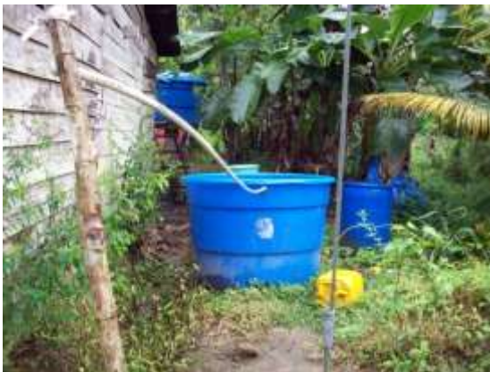
Imagen 5: Tanque de aguas lluvias 2
