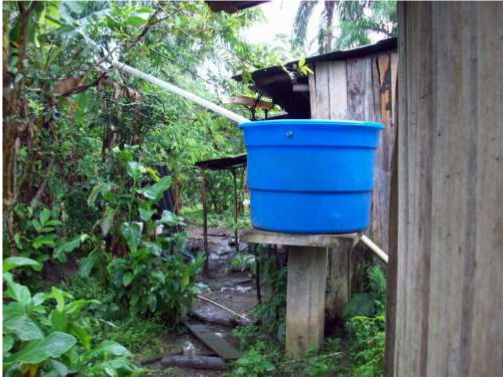
Imagen 4: Tanque de agua lluvia 1
