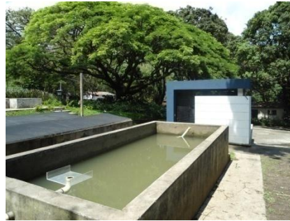
PLANTA DE AGUA
