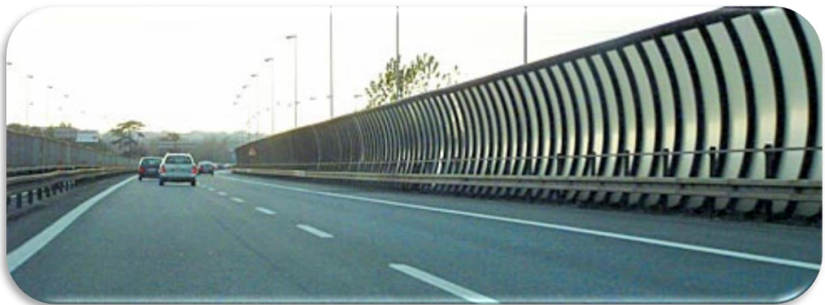
Barreras acústicas en acrílico utilizadas para aislar el ruido de las grandes avenidas de las zonas aledañas a través de la reflexión.
