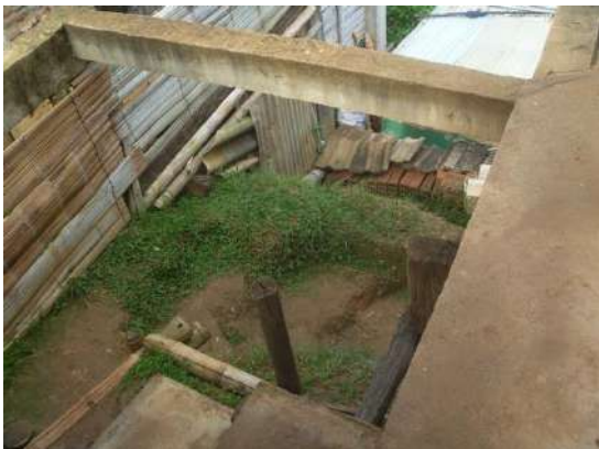
En la foto: Estructuras de casa en cemento. Se puede ver la inclinación de la ladera donde se sitúan las casas.
