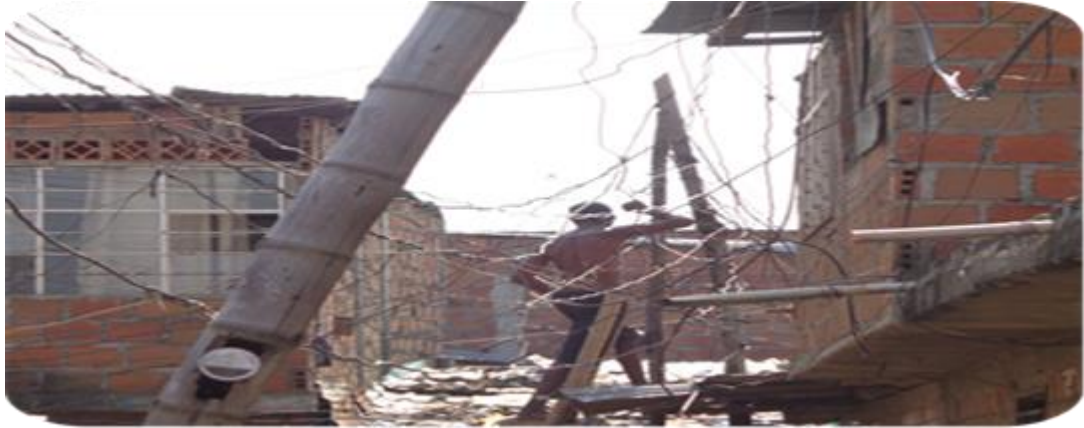
Figura 3. Riesgo eléctrico por manipulación de redes antitécnicas.
